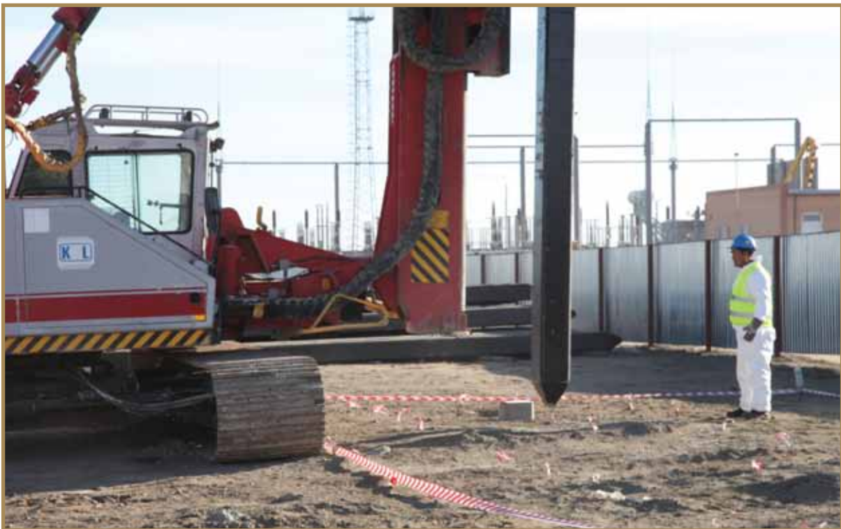
МТӨК құрылыс алаңына алғашқы қаданы орнату. Қазан 2012 ж. Забивка первой сваи на строительной площадке КГПН. Октябрь 2012 г. Driving the first pile at Deep Oil Conversion Complex construction site. October, 2012
