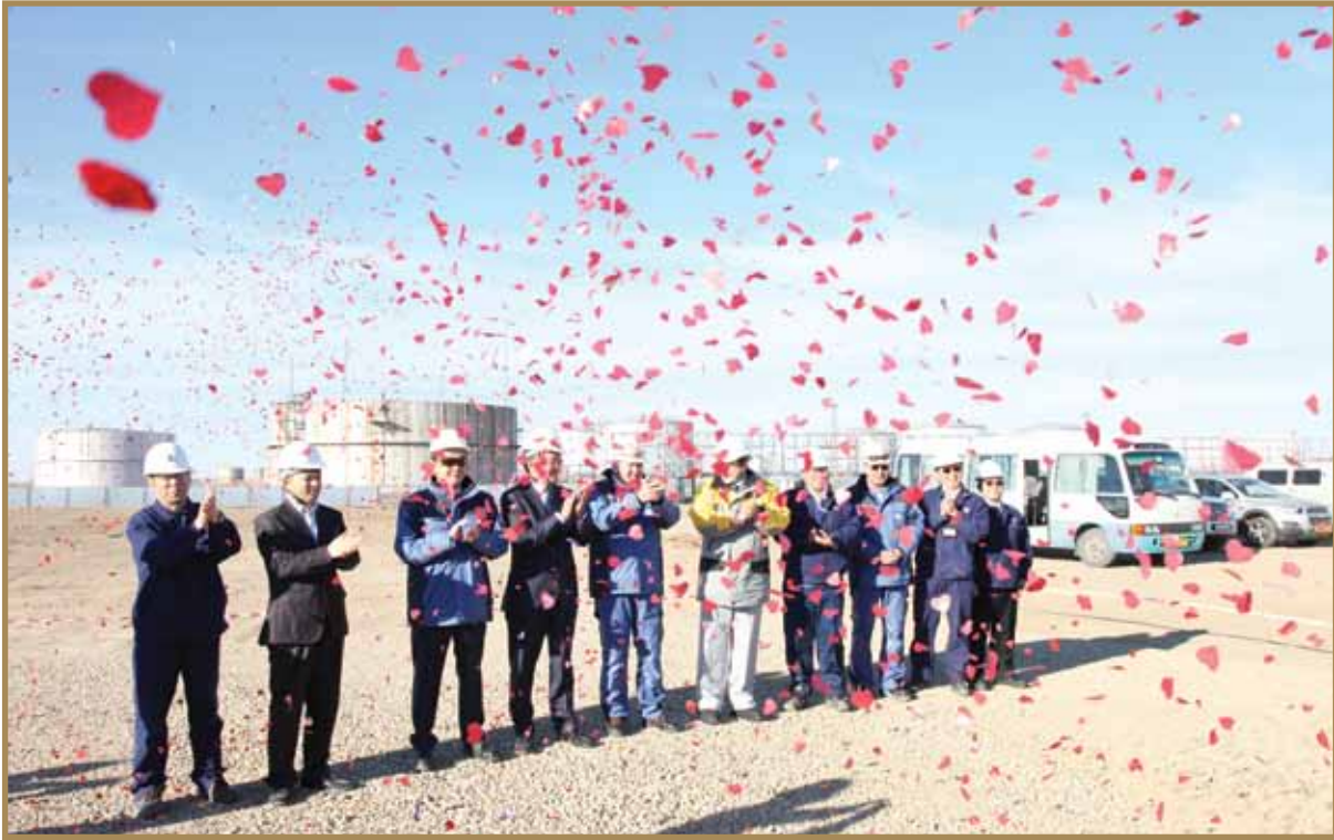
МТӨК құрылыс алаңына алғашқы қаданы орнату. Қазан 2012 ж. Забивка первой сваи на строительной площадке КГПН. Октябрь 2012 г. Driving the first pile at Deep Oil Conversion Complex construction site. October, 2012
