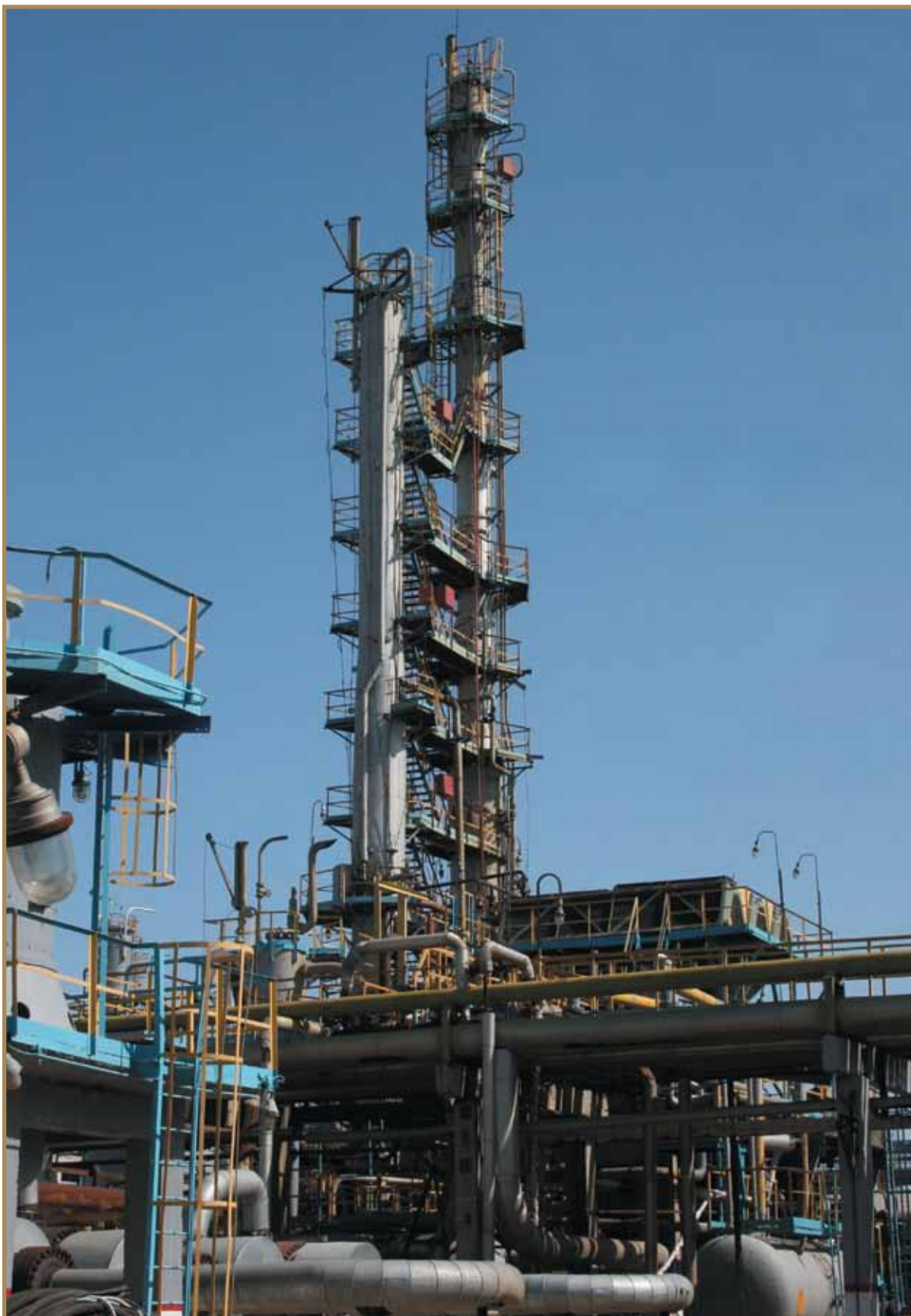
1971 жылы пайдалануға берілген каталикалық риформинг қондырғысы Установка каталитического риформинга, введенная в эксплуатацию в 1971 году Catalytic Reforming Unit put into operation in 1971
