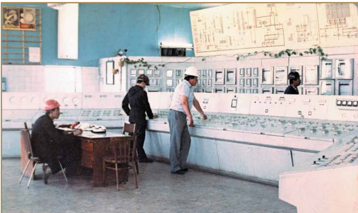
Каталитикалық реформинг қондырғысының операторлық бөлмесі Операторная установки каталитического реформинга Control room of the Catalytic Reforming Unit
