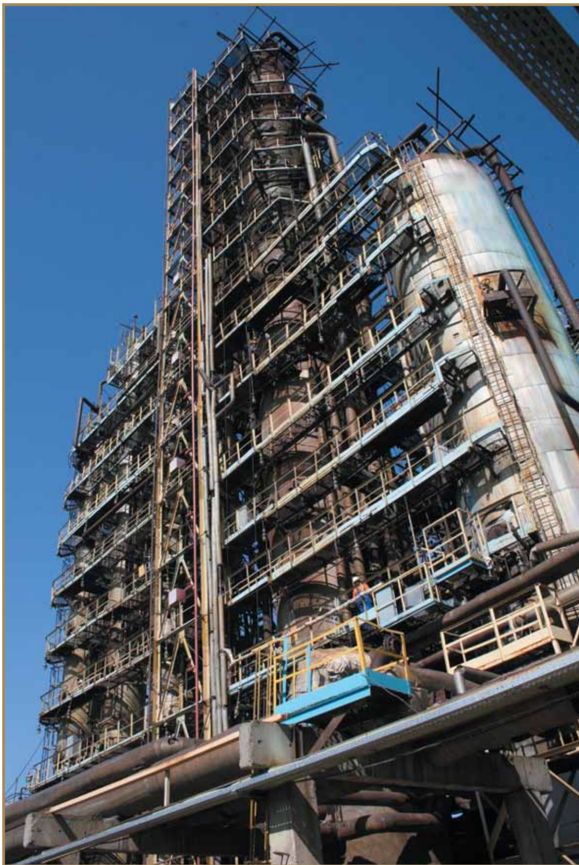
ЭЛОУ-АВТ-3 қондырғысы Установка ЭЛОУ-АВТ-3 Crude Vacuum Unit
