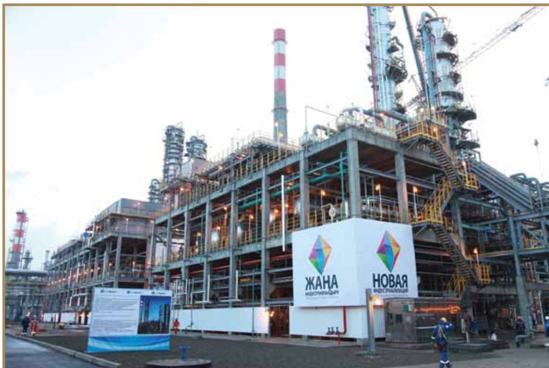
Бензолды бөліп шығару блогы бар катализаторды үздіксіз регенерациялайтын каталитикалық риформинг қондырғысы 25 желтоқсан 2014 ж. Установка каталитического риформинга с непрерывной регенерацией катализатора с блоком извлечения бензола. 25 декабря 2014 г. Catalytic Reforming Unit with Continuous Catalyst Regeneration and Benzol Extraction Section. December 25, 2014
