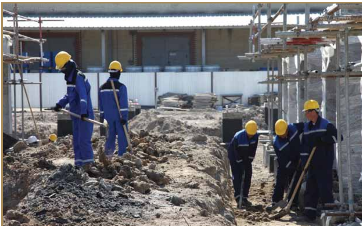
МТӨК алаңындағы құрылыс жұмыстары Строительные работы на площадке КГПН Deep Oil Conversion Complex construction
