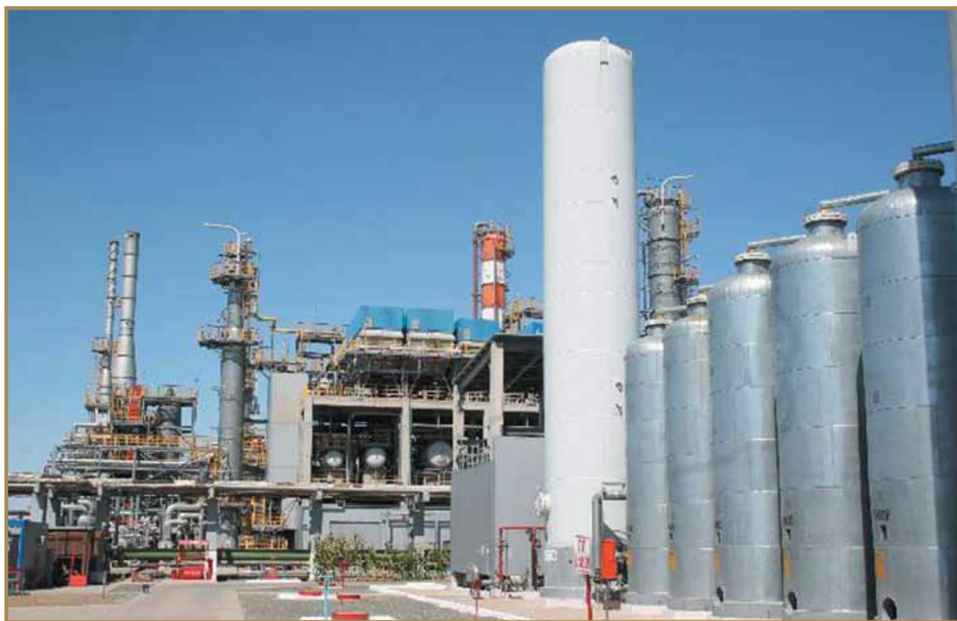
Сутек өндіру қондырғысы Установка по производству водорода Hydrogen Production Unit
