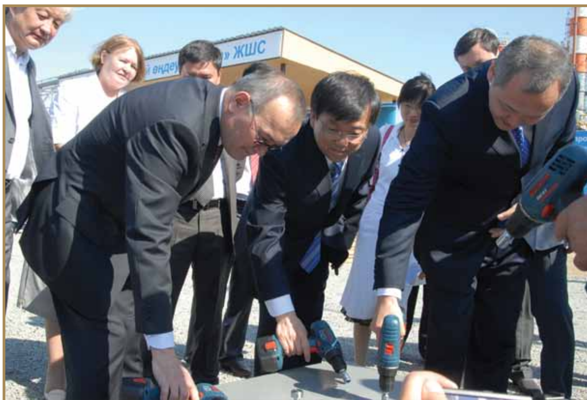
АКӨК құрылысының іргетасына алғаш тас қалау. 4 қыркүйек 2010 ж. Закладка первого камня в фундамент строительства КПА. 4 сентября 2010 г. Laying the first stone into the foundation of Aromatics Production Plant. September 4, 2010
