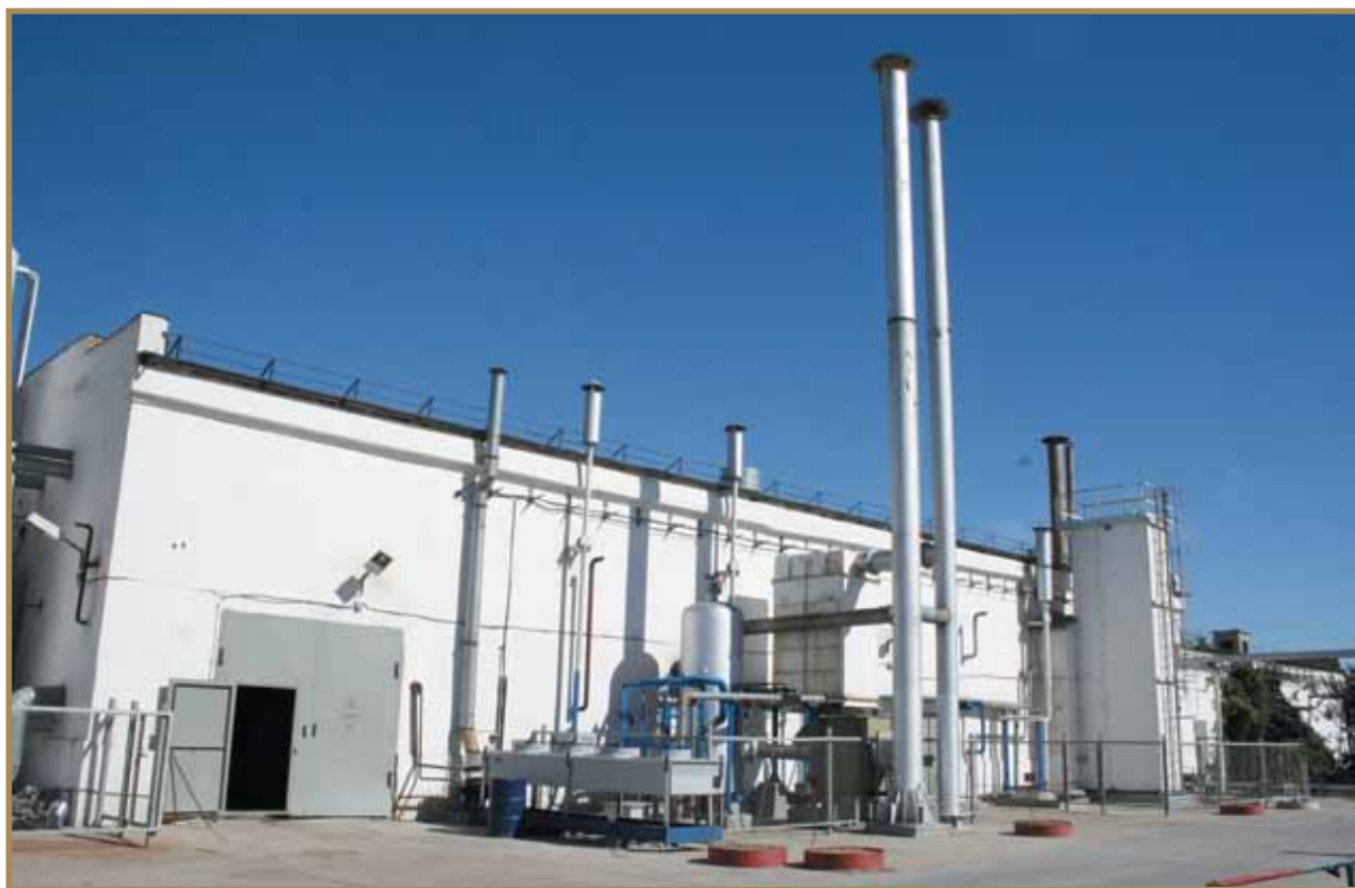
Техникалық азот өндіру қондырғысы Установка по производству технического азота Technical nitrogen production unit
